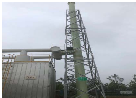
图 4-2 除臭系统排气筒
