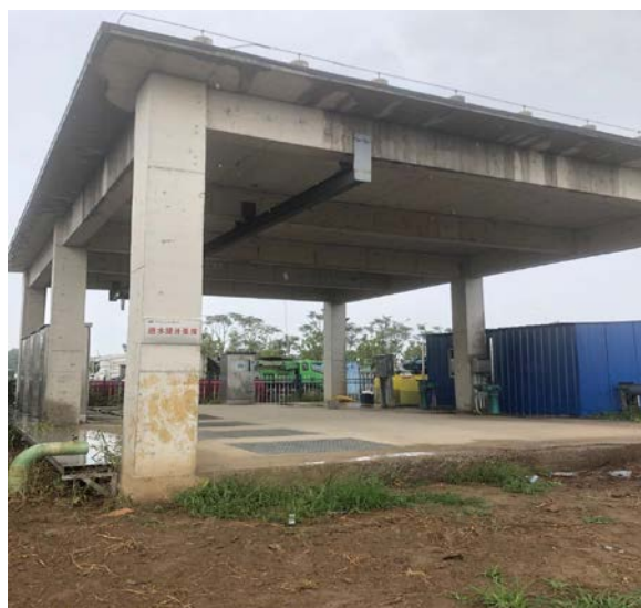
粗格栅进水泵房
