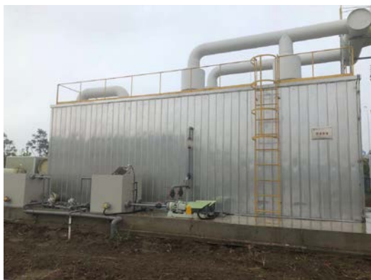
图 4-1 除臭系统照片
