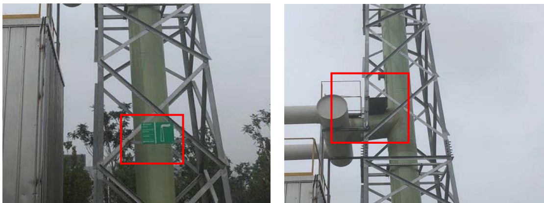
图 4-9 生物除臭系统排气筒标志牌及采样口
